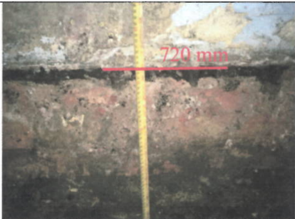
Foto Nr. 3 – gruntsūdens līmenis
